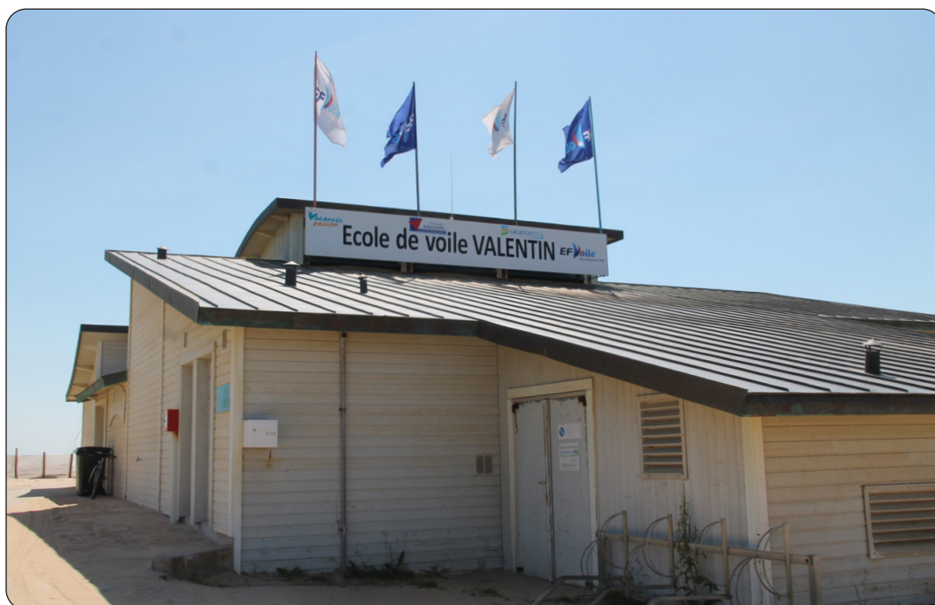
Enseigne en toiture, illégale car elles ne sont pas réalisées en lettres découpées (concerne les drapeaux)
